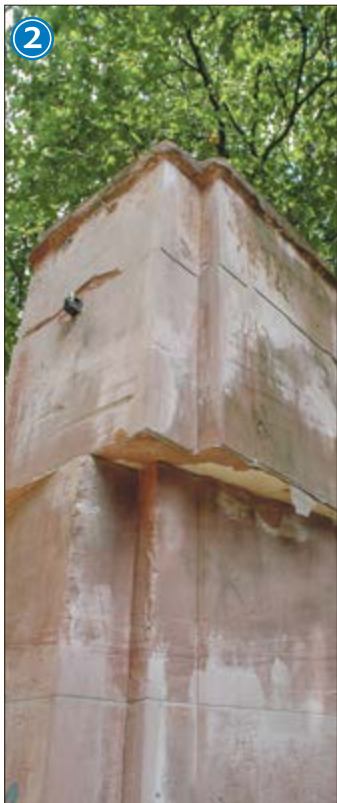
... im August des gleichen Jahres rammte ein Lkw beim Rangieren das gesamte Portal schwer und beging Fahrerflucht ...
